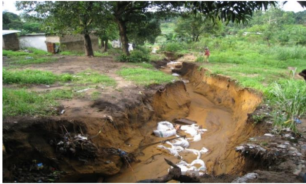
Photo 1 : Quartier Mikalou- Madzouna, dégradation d'une rue par l'érosion en ravine
